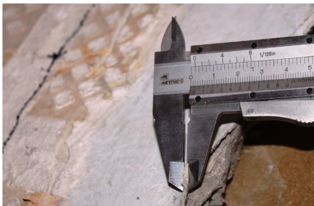
Figur 4: I undersøkelsene inngår vurdering av membranens tilstand bl.a tykkelse, fabrikk og alder.
